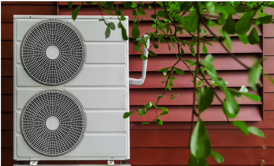
Pompă de căldură aer-apă instalată în exterior
